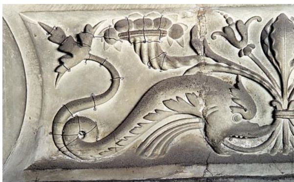
Listwa kopuły ze stworami morskimi. Zabrudzenie powierzchni i wzmocnienia z drutów srebrnych z lat pięćdziesiątych ubiegłego wieku
