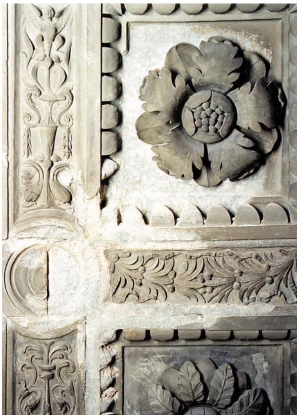
Typowe zniszczenia kamienia na ornamentach kasetonowych kopuły
