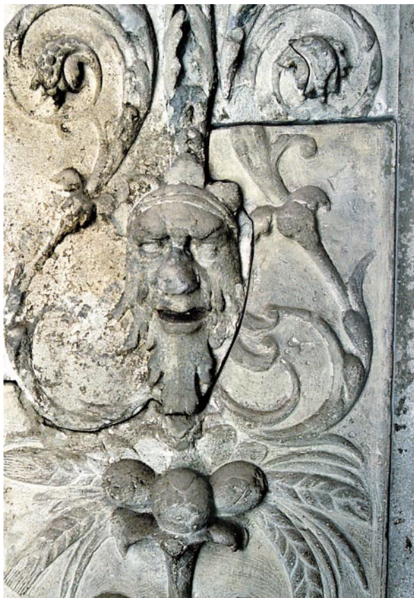
Zbliżenie powierzchni ornamentu groteskowego. Zniszczony fragment oryginału uzupełniony rekonstrukcją z końca XIX wieku
