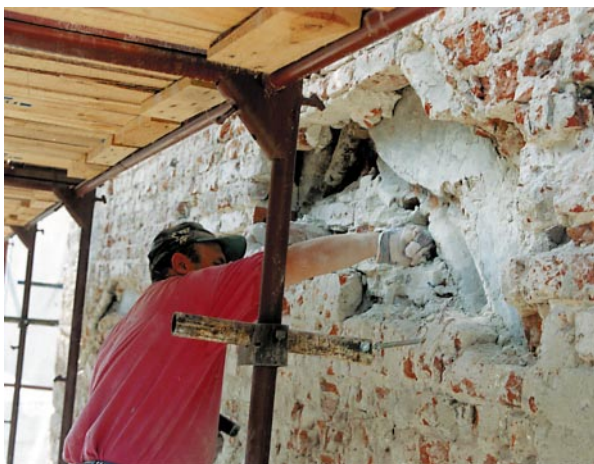
Olsztyn, Stary Ratusz, elewacja wschodnia w trakcie odsłonięcia portalu. Stan z sierpnia 2002 r. Fot. W. Chodkowska
