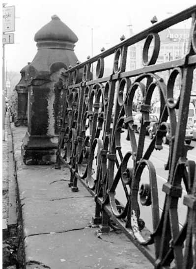
Zniszczone dekoracyjne barierki metalowe (Fot. M. Majewski)
