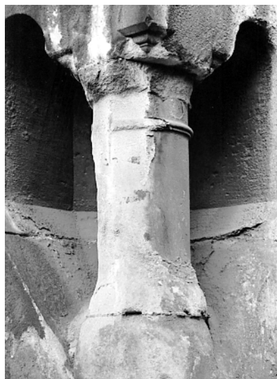
Fragment narożnej niszy z kolumnką. Poważne zniszczenia struktury kamienia (Fot. M. Majewski)
