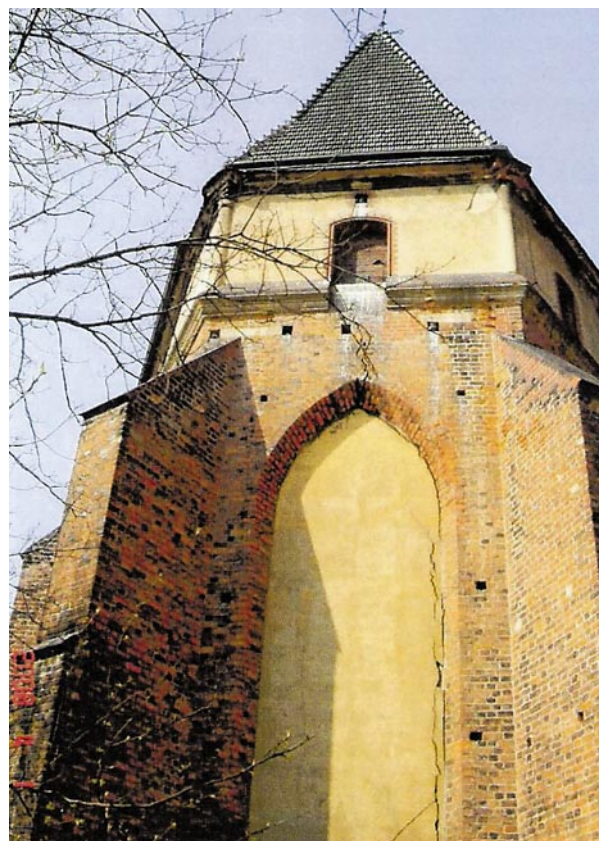
Ryc. 17. Ściana wschodnia prezbiterium – górna i środkowa partia ściany. Pionowe pęknięcie biegnące przez całą wysokość ściany. Pęknięcie wydziela blendę otworu okiennego Fig. 17. East wall of the presbytery – upper and middle part of the wall. A vertical crack running the whole height of the wall. The crack highlights the blind window opening
