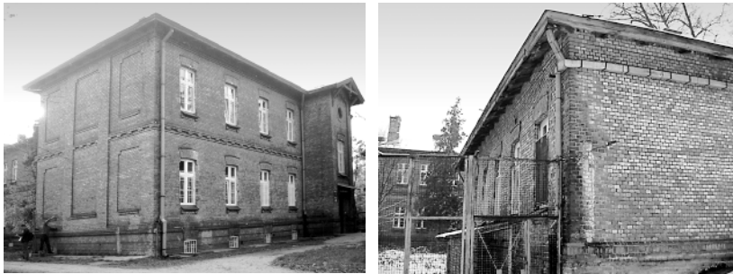
Ryc. 5, 6. Stan techniczny ceglanych elewacji pawilonu Fig. 5, 6. Technical condition of brick elevations of the pavilion
