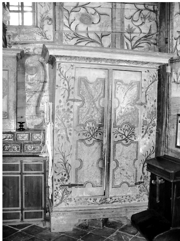
Ryc. 7. Binarowa. Zakrystia. Szafa przechylona wskutek zapadnięcia się części posadzki. Fot. Jan Janczykowski, czerwiec 2010 Fig. 7. Binarowa. Sacristy. Cupboard tilted because a part of the floor caved in. Photo Jan Janczykowski, June 2010
