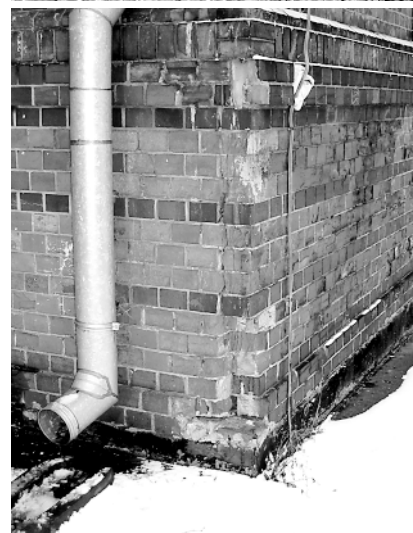
Ryc. 8, 9. Stan techniczny ceglanych elewacji pawilonu. Uszkodzenia dolnej części murów wynikające z dużego zawilgocenia, korozji mrozowej i obecności soli rozpuszczalnych [2] Fig. 8, 9. Technical condition of brick elevations of the pavilion. Damage of the bottom section of the wall resulting from excessive moisture, frost corrosion and the presence of soluble salts [2]
