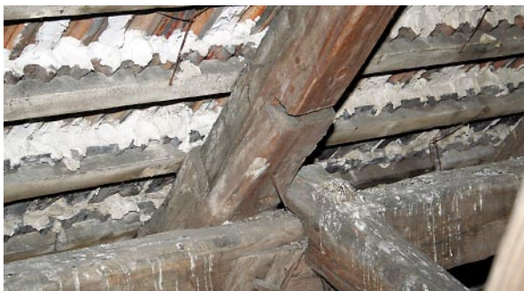
Ryc. 6. Niewłaściwe połączenie w miejscu sztukowania krokwi na płatwi Fig. 6. Incorrect joining in the place where rafter was lengthened on the purlin
