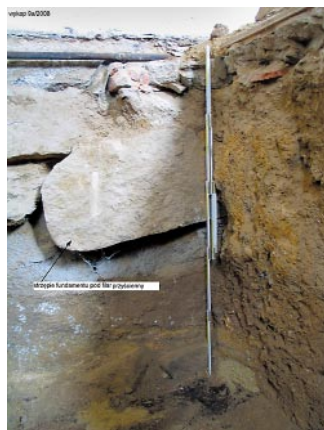
Ryc. 1. Widok na fragment zachowanego fundamentu pod filar przysięenny. Fot. K. Stala
