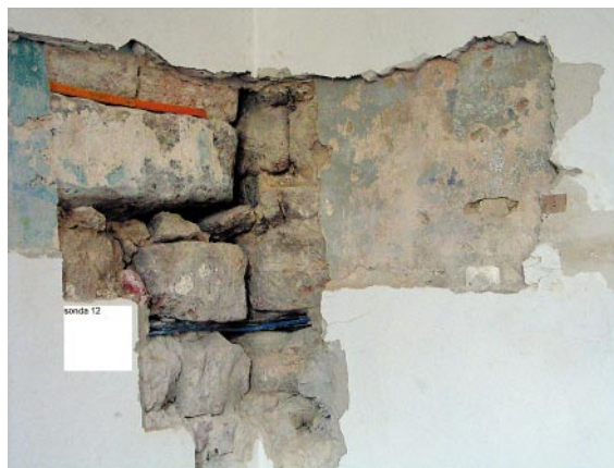
Ryc. 2. Widok na odsłonięte spod tynku lico ściany zachodniej przystawionej do muru magistralnego budowli romańskiej z wyraźną dylatacją. Fot. K. Stala
