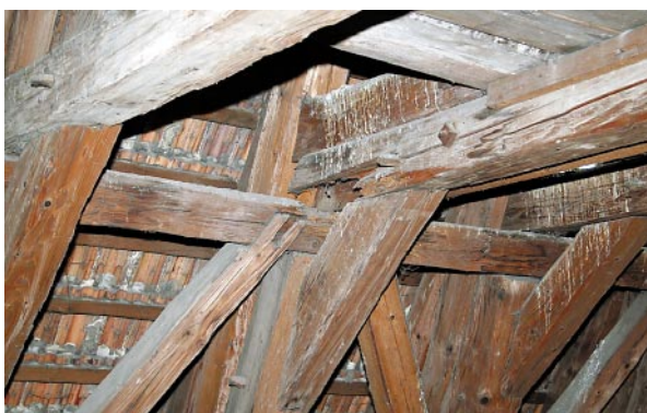
Ryc. 5. Jętka wzmocniona jednostronną nakładką drewnianą łączoną za pomocą śrub. Przekrój jętki w połączeniu całkowicie zniszczony przez grzyby Fig. 5. Collar beam strengthened with a one-side wooden cover plates fixed with bolts. Cross section of the collar beam in the joint completely destroyed by fungi
