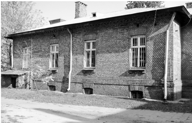
Ryc. 7. Poziom terenu znajduje się powyżej opaski wokół budynku. Brak odpowiedniej niwelacji terenu [1] Fig. 7. Ground level is located slightly above the finish casing round the building. Lack of appropriate ground levelling [1]
