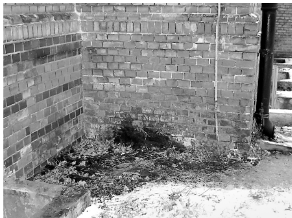
Ryc. 16. Strefa przyziemia budynku. Korozja biologiczna muru – glony, mchy [2]
