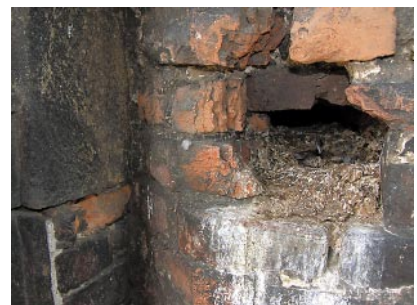
Ryc. 33. Wątek ceglany poddany konserwacji w 2010 roku. Widoczne zniszczenia cegieł i spoin oraz gniazdo ptasie wraz ze szkodliwymi odchodami w miejscu dużego ubytku wątku – obraz przed konserwacją Fig. 33. Brick bond which underwent conservation treatment in 2010. Visible damage to bricks and joints, and a bird nest with harmful droppings in the place where a large section of bond is missing – view before conservation
