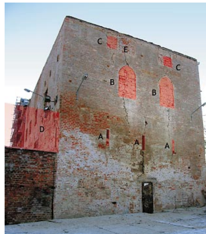
Ryc. 9. Elewacja północna skrzydła zachodniego (od strony suchej fosy), powstałego w fazie II (mury gotyckie zachowane niemal do korony – bez kilku ostatnich warstw), po skuciu tynków. A – strzelnice szczelinowe; B – ostrołukowe blendy piętra, w których znajdowały się otwory zamknięte odcinkiem łuku; C – otwory obronne poddasza; D – pierwotna wysokość kurtyny północnej przedzamcza (ustalona na podstawie analizy narożnika skrzydła zachodniego); E – wtórne otwory z fazy V. Fot. L. Wawrykiewicz, 2010
