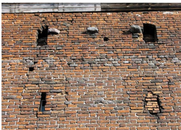
Ryc. 9. Południowa ściana baszty z zachowanymi zwężonymi oknami i kamieniami impostowymi Fig. 9. The south wall of the tower with preserved narrow windows and impost stones
