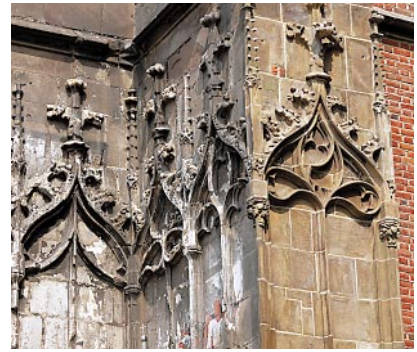
Ryc. 17. Uszkodzona i odnowiona dekoracja rzeźbiarska elewacji przypór południowych (rok 2011) Fig. 17. Damaged and renovated sculpting decoration of the elevation and southern buttresses (2011)
