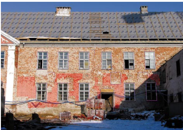
Ryc. 20. Południowy odcinek elewacji dziedzińcowej skrzydła wschodniego po skuciu tynków. Kolorem czerwonym podkreślono relikty gotyckie z fazy II, w tym szwy po pierwotnych otworach, czarnym zaś pozostałości dekoracji gotyckiej wykonanej z główek cegły zendrówki. Liniami jasnozielonymi zaznaczono otwory z fazy V, jasnofioletowymi z etapu I fazy VI. Fot. L. Wawrykiewicz, 2010 Fig. 20. The southern section of the courtyard elevation in the east wing after hacking off plaster. Red colour marks Gothic relics from phase II, including seams after original openings, while black marks relics of Gothic decoration made from headers of ceramic brick. Light green lines indicate openings from phase V, light purple from stage I of phase VI. Photo by L. Wawrykiewicz, 2010
