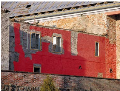
Ryc. 8. Skrzydło południowe i wschodnie po skuciu tynków w widoku od południa. A – południowa kurtyna przedzamcza z fazy I (po lewej relikty łuku bramy wjazdowej oraz zaplanowane strzypia pod budynek bramny); B – południowa ściana skrzydła wschodniego z fazy II postawiona na dolnej partii kurtyny południowej z fazy I, górą dostawiona do jej skutego muru. Kolorem jasnozielonym zaznaczono otwory z fazy V, pomarańczowym z etapu I fazy VII. Fot. L. Wawrykiewicz, 2010
