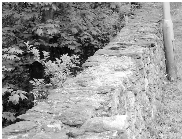
Ryc. 3. Ubytki kamiennych elementów murowych korony muru obwodowego Niemczy, woj. dolnośląskie (fot. W. Misztal) Fig. 3. Loss of masonry components in crest of perimeter wall of Niemcza (Lower Silesian Province; photo by W. Misztal)
