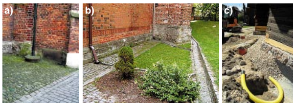
Ryc. 7. Przykłady odprowadzenia wód opadowych: a) kościół pw. św. św. Jerzego i Wojciecha w Zatorze, b) kościół pw. św. Jakuba w Sandomierzu, c) kościół pw. św. Rocha w Radomsku (zdjęcia: autor) Fig. 7. Examples of channelling of precipitation water: a) the church of St. George and Wojciech in Zator, b) the church of St. James in Sandomierz, c) the church of St. Roch in Radomsko (photos: author)
