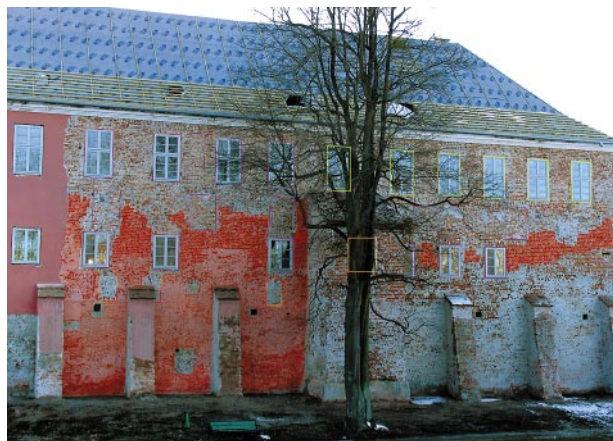
Ryc. 17. Północny odcinek elewacji wschodniej skrzydła wschodniego po skuciu tynków. Kolorem czerwonym podkreślono relikty gotyckie z fazy II. Liniami czerwonymi zaznaczono szwy po gotyckich otworach okiennych z fazy II, jasnozielonymi – z fazy V, jasnofioletowymi – z etapu I fazy VI, pomarańczowymi – z etapu I fazy VII, żółtymi – z etapu II fazy VII. Fot. L. Wawrykiewicz, 2010
