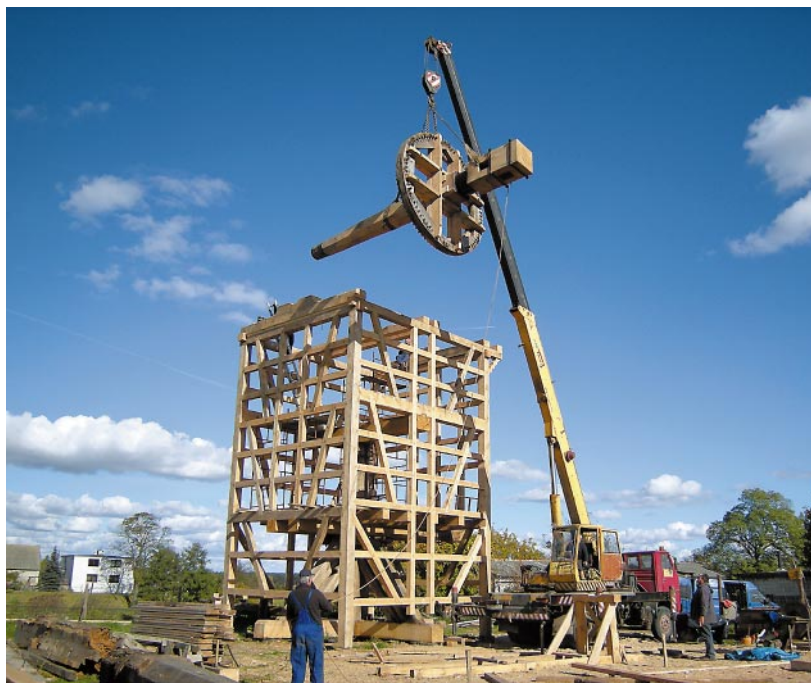
Ryc. 13. Bierzłowo, wiatrak koźlak z 1867 r. Montaż wału głównego z kołem palecznym podczas prac konserwatorskich prowadzonych od sierpnia 2010 (fot. M. Prarat, 2010) Fig. 13. Bierzłowo, post mill from 1867. Mounting of the main shaft with break wheel during conservation work carried out since August 2010 (photo by M. Prarat, 2010)
