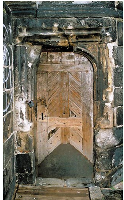
Ryc. 19. Portal wejściowy do dzwonnicy – widok przed konserwacją (rok 2004) Fig. 19. Entrance portal to the bell tower – view before conservation (2004)
