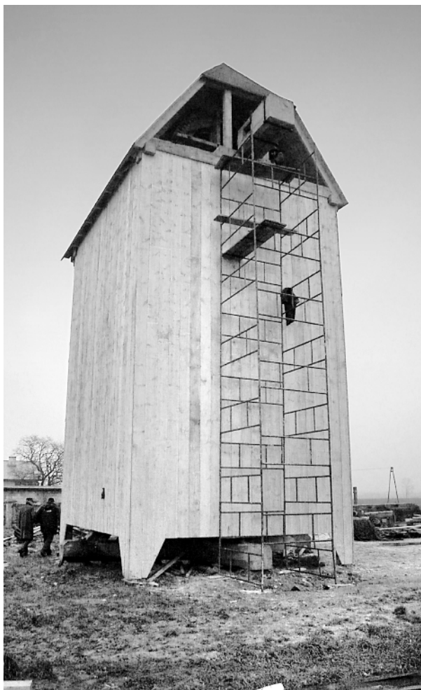
Ryc. 14. Bierzysłowo, wiatrak koźlak z 1867 r. Widok ściany odwietrznej po przeprowadzonych pracach konserwatorskich. Stan z listopada 2010 r. (fot. M. Prarat, 2010)
