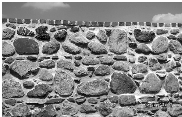
Fot. 23. Dodatkowe zabezpieczenie korony muru, warstwa cegieł na zaprawie murarskiej TWM Photo 23. Additional protection for the top of the wall, a layer of bricks on masonry mortar TWM
