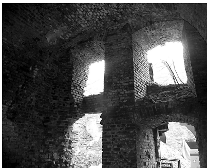
Fot. 6. Ściana przed renowacją, widok od wewnątrz Photo 6. Wall before renovation, view from inside
