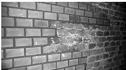
Fot. 9. Fragment ściany po renowacji, widoczne połączenie nowego muru ze starym Photo 9. Wall fragment after renovation, visible borderline where the new wall joined the old
