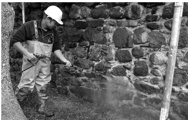
Fot. 19. Mycie muru wodą pod ciśnieniem Photo 19. Clearing the wall with pressurized water.
