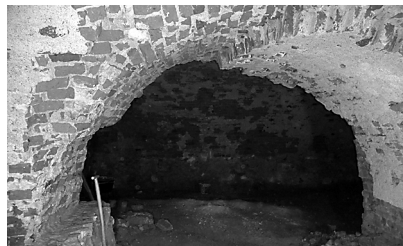
Fot. 12. Łuk ceglany przed renowacją Photo 12. Brick arch before renovation
