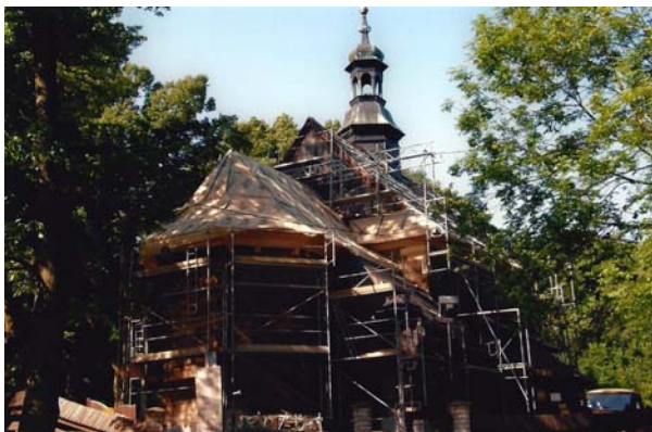
Ryc. 13. Wymiana pokrycia dachowego oraz szalunku ścian. Widok od strony prezbiterium, maj 2012 r. Fig. 13. Replacing the roof covering and wall shoring. View from the presbytery, May 2012.
