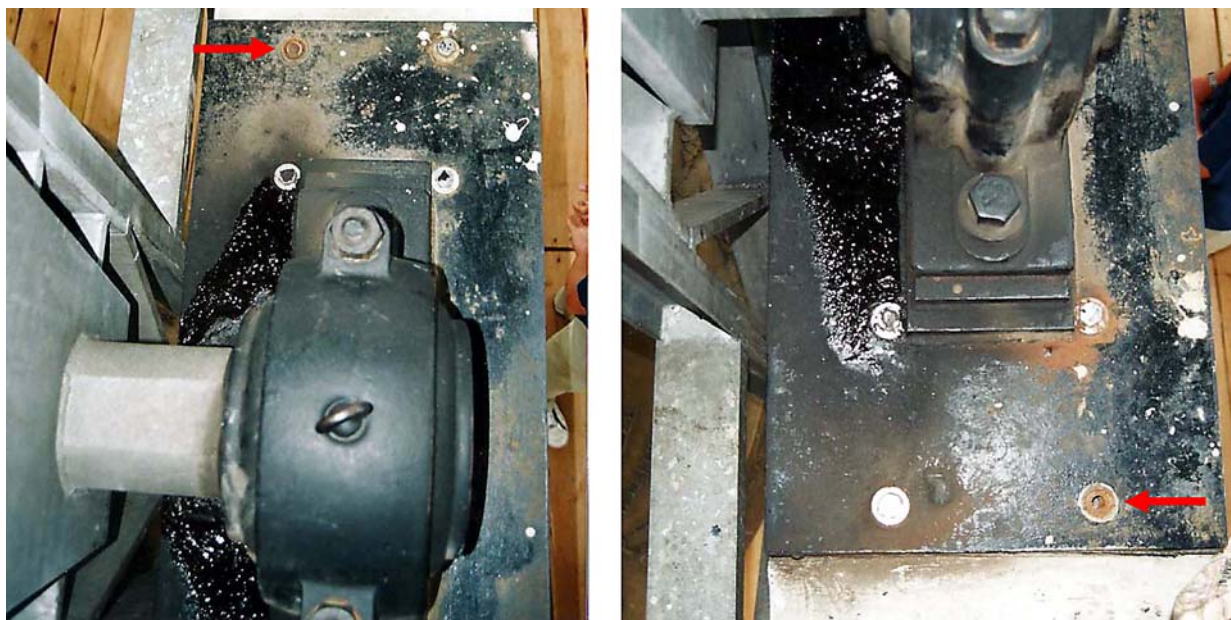
Ryc. 15. Ścięte śruby mocujące podstawę łożyska dzwonu do belki żelbetowej
