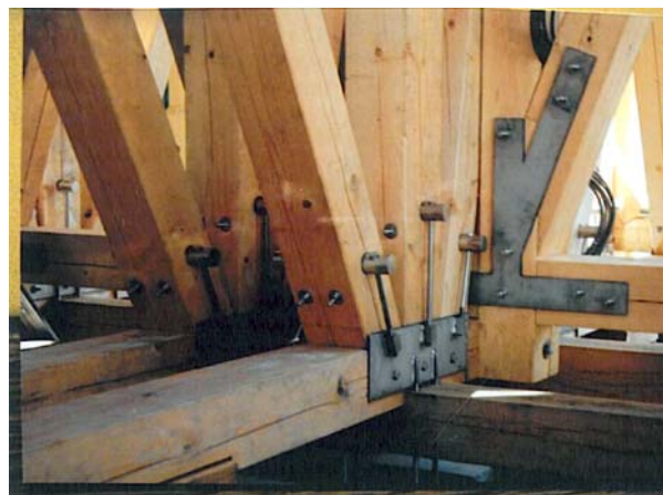
Ryc. 21. Przykład wzmocnienia węzła przy użyciu płaskowników stalowych, kościół św. Stanisława, św. Doroty i św. Wacława we Wrocławiu
