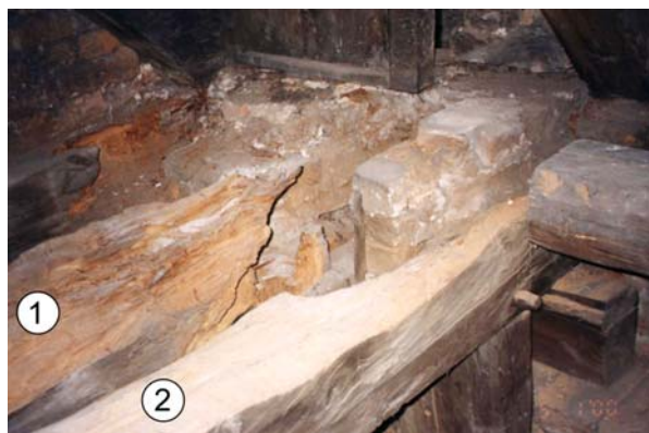
Ryc. 12. Uszkodzone końce belek nad nawą kościoła farnego w Poznaniu
