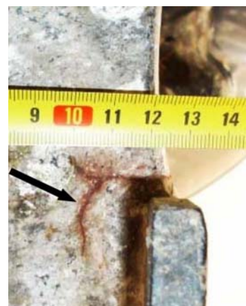
Ryc. 18. Pęknięcie płaskownika Fig. 18. Crack in flat steel
