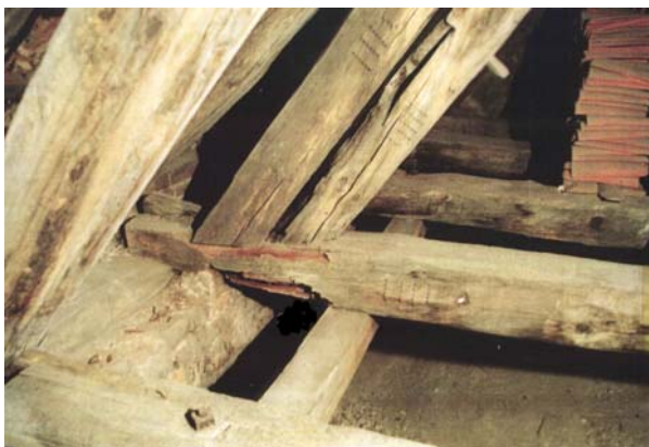
Ryc. 30. Zniszczona belka stropowa w węźle podporowym wiązara pełnego Fig. 30. Destroyed floor beam at the support joint of the main truss
