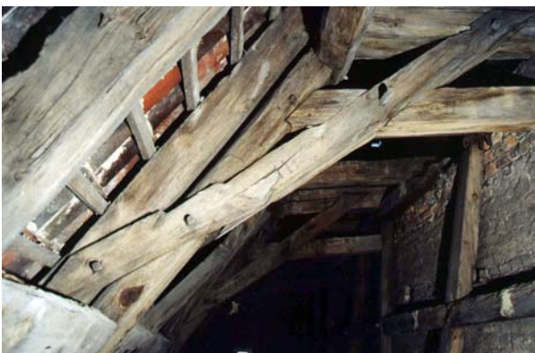
Ryc. 24. Złamany zastrzał w nawie bocznej
