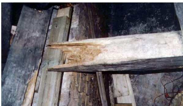
Ryc. 19. Przykład uszkodzenia końcówki belki stropowej przez grzyb domowy Fig. 19. Example of damage to a floor beam tip due to house fungus
