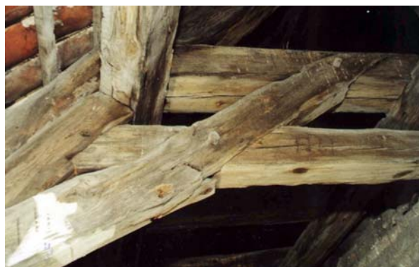
Ryc. 25. Złamany zastrzał w nawie bocznej
