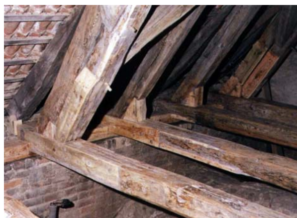
Ryc. 31. Zrekonstruowane węzły podporowe – widok z lewej Fig. 31. Restored support joints – left-side view
