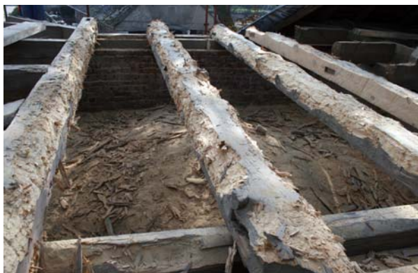
Ryc. 6. Przykład powierzchniowego uszkodzenia belek stropowych spowodowanego przez owady – techniczne szkodniki drewna (kościół pw. św. Idziego w Czerwonej Wsi)
