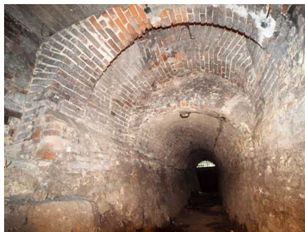
Ryc. 5. Wnętrze kanału pod przeoratem z widocznymi ceglany arkadami wspierającymi sekcję z dwiema wczesnonowożytnymi latrynami
