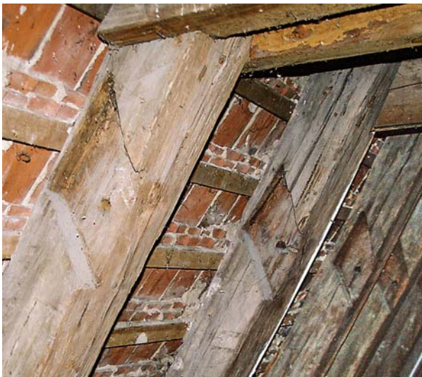
Ryc. 2. Gniazda w krokwiach w starszej części nawy po usunięciu zastrzałów podporowych Fig. 2. Sockets in the rafters in the older nave fragment where the support braces were removed
