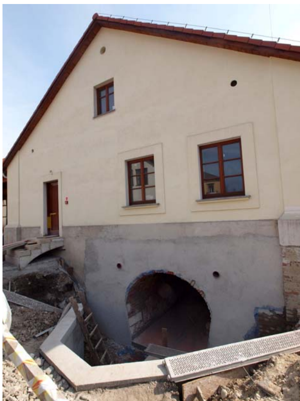
Ryc. 17. Zachodnia elewacja budynku barokowego z włotem kanału i ostrogą zrekonstruowanego mostku na korycie młynówki
