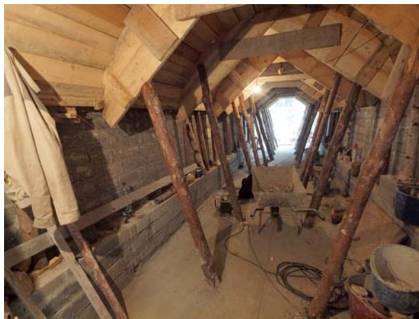
Ryc. 12. Wnętrze kanału pod budynkiem barokowym w trakcie przemurowywania ścian podłużnych; kolebka zabezpieczona krężyną i stemplami
