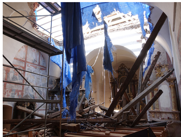
Ryc. 3. Zawalone sklepienie, ściana szczytowa oraz część więźby dachowej. Ponad zawalonym sklepieniem widoczna (w budowie) konstrukcja tymczasowego zadaszenia (fot. P. Opałka, 6.06.2018)
